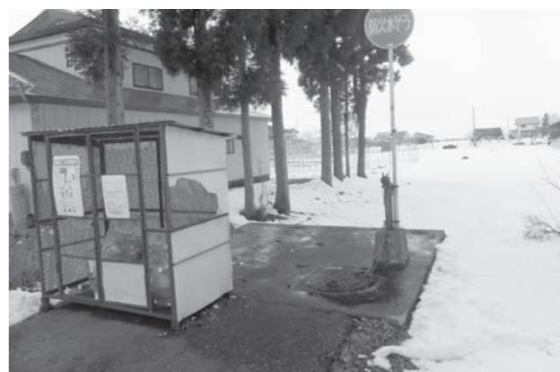
明田地域内の防火水槽
