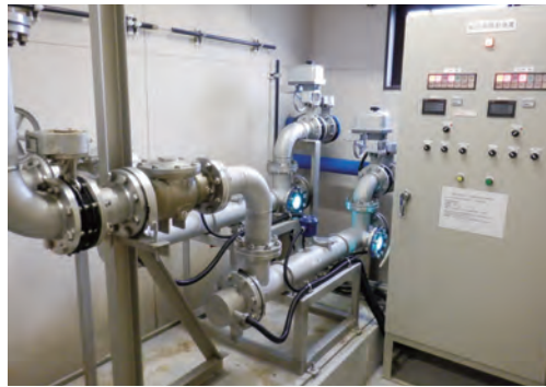
紫外線処理（仙南中央浄水場）
