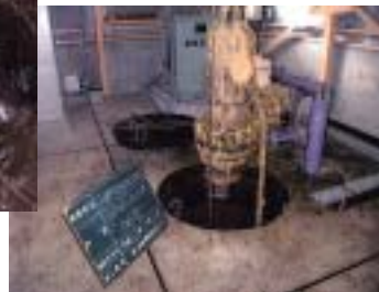
▼油まみれになった水中ポンプ
